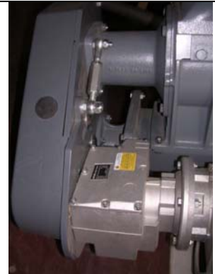
Foto 4 Aandrijving sluis Transportschroef
