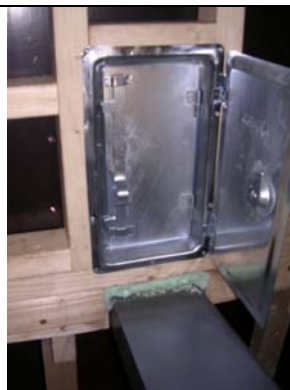
Foto 6 Luik boven Transportschroef Gesloten
