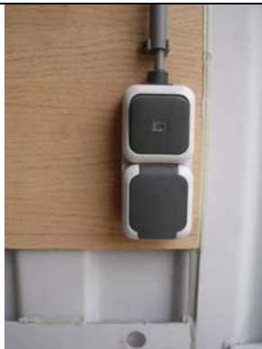
Foto 9 Schakelaar WDC IP 54
