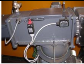
Foto 2 Transportschroef Sluis Veiligheidsschakelaar
