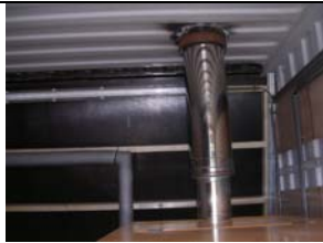
Foto 16 Rookgassen afvoer. RVS geïsoleerd
