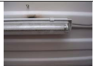
Foto 11 TL armatuur IP 54
